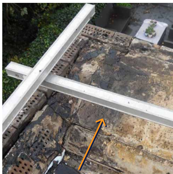
Foto 3: opname hoek zijgevel/opbouw en badkuip-opstand en zijmuur begane grond hoekpand (holle steen) met spouw.
