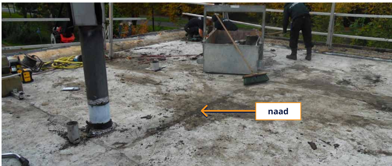
Foto 1: gestriipt dak (van 2 aangrenzende woningen)
